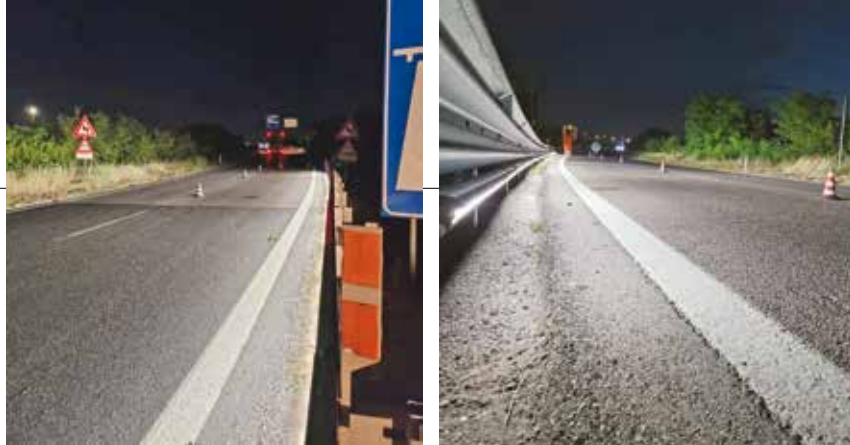
3A e 3B. Vista della carreggiata sinistra (3A) e destra (3B) con sistema G-light
